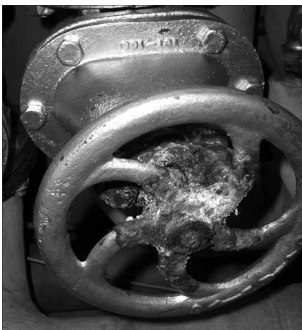
Den sämsta av alla situationer. Det här är en avstängningsventil i föreningen som har rostat ihop. Om det börjar läcka är det inte ens säkert att det går att stänga av vattnet. Skadorna kan bli stora - i samband med kulvertrenoveringen byts därför successivt många av avstängningsventilerna.
